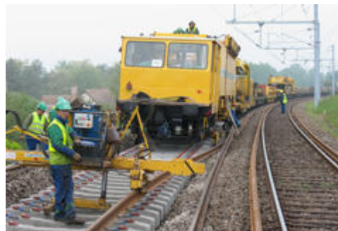
Longs Rails soudés sur traverses béton
